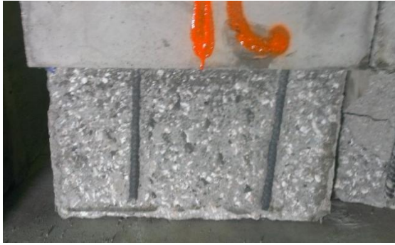
b) Bond interface (substrate concrete)
